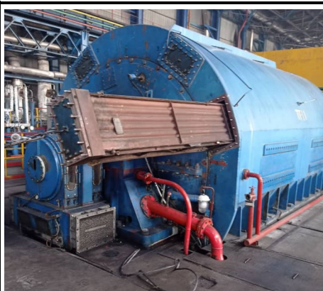
Рис. 2. Загальний вигляд газоохолоджувача турбогенератора
